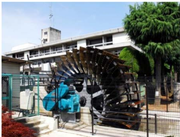
元気くん1号 流量：最大2.0m 3 /s 有効落差：最大2.0m 出力：22kW
