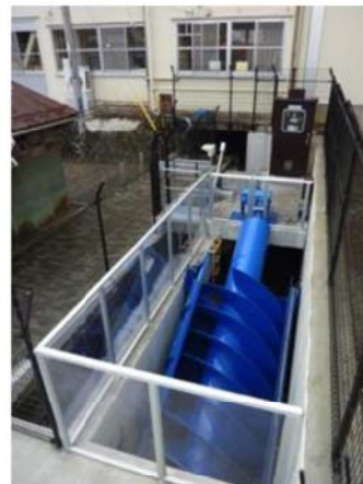
元気くん3号 流量：最大0.99m 3 /s 有効落差：最大1.0m 出力：7.3kW
