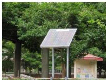
ソーラーパネル: 発電した電気は蓄電池へ。 災害時にも活用できる。
