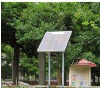
ソーラーパネル: 発電した電気は蓄電池へ。 災害時にも活用できる。
